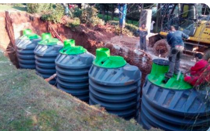
Photo 5 : Réservoirs installés et rangés
